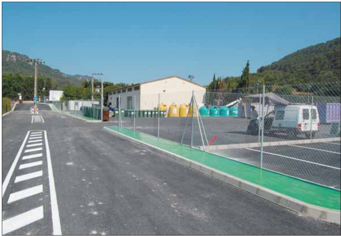
Noves instal·lacions per la separació i tractament dels residus.
